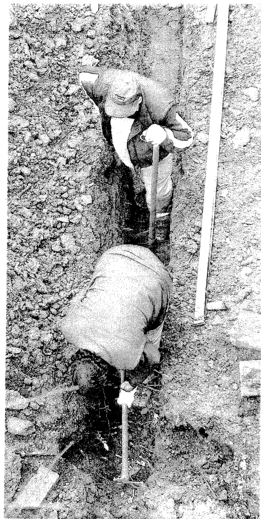
PROBLEMA La frana di Polcanto è ancora lì, nonostante le promesse di far partire i lavori entro l'estate
